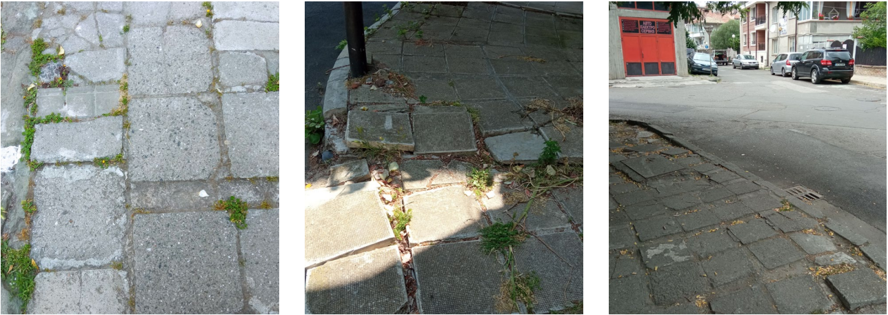
Рис. 1. Ділянки зі зруйнованими покриттями на вулицях Царь Арсен, Хаджи Димитр та Солна у м. Поморіє, Болгарія
